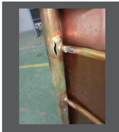
FIGURA 20. Dëmtimi i gypave të kolektorit shkaku i ngrirjes së fluidit punues
