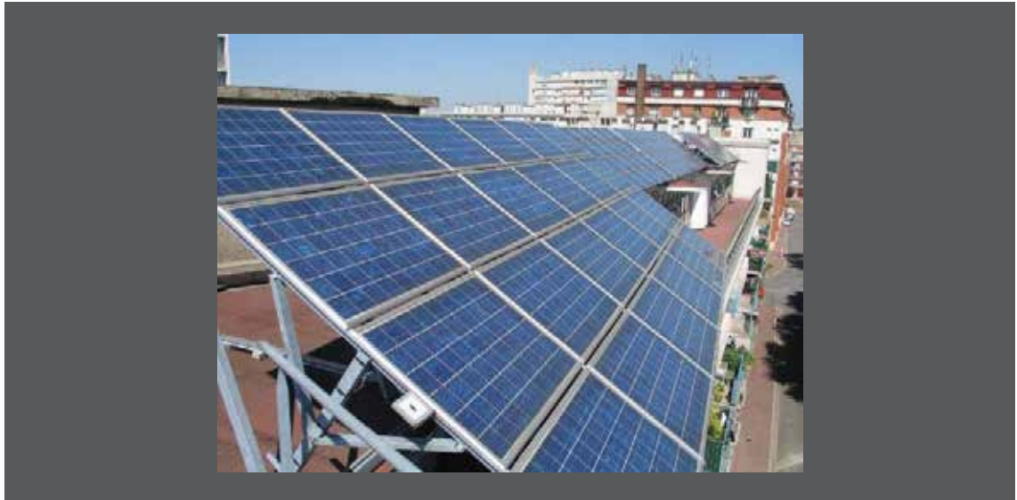
FIGURA 25. Sistem fotovoltaik i vënë në çatinë e objektit
