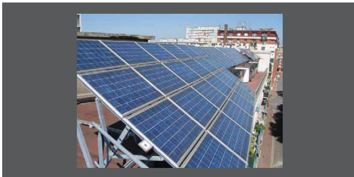
СЛИКА 25. Фотоволтаичен систем поставен на покрив од објект
