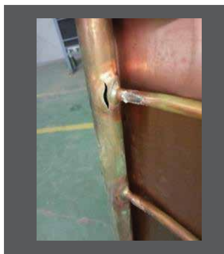
СЛИКА 20. Оштетување на цевките од колекторот поради замрзнување на работниот флуид
